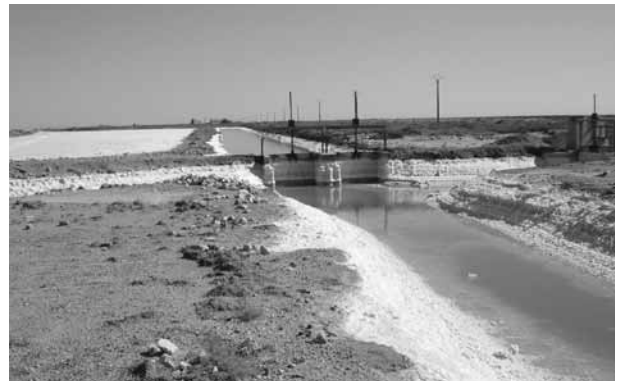
Photo 5. Salin de Giraud : porte martelière et dépôts salins sur un canal de transfert des eaux chargées en sel (cliché Gérard Sustrac).
