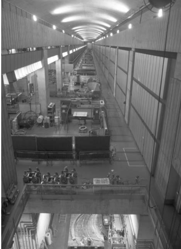
Photo 3. La salle des machines (cliché EDF Médiathèque C. Cieutat).
