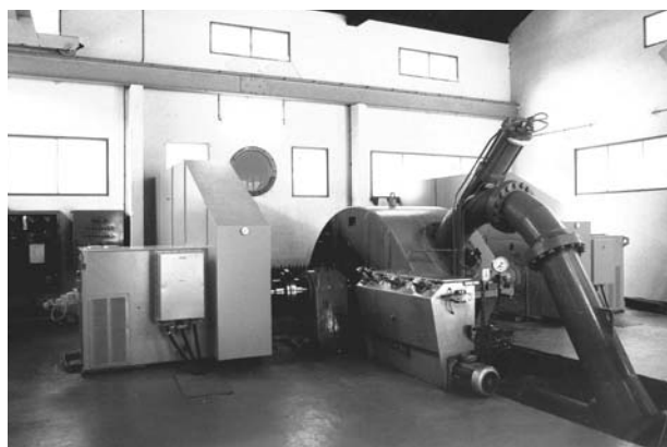
Photo 5. Groupe de la centrale de haute chute du Martinet à Méolans, 04 (droits réservés).
